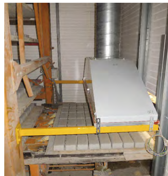
Jedna z dwóch podgrzewanych pokryw zainstalowanych między windą piętrującą i rozpiętrującą oraz ścianą komory, które zapobiegają wystąpieniu ciepłego i wilgotnego powietrza, a tym samym skraplaniu się wody na świeżo wyprodukowanych wyrobach.
