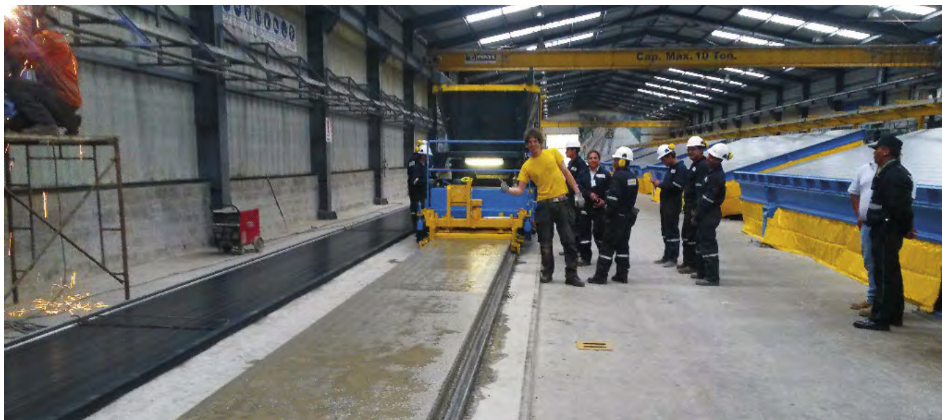
Sprężone płyty stropowe produkowane są na dwóch torach naciągowych o długości 114 m za pomocą systemu betonowania ślizgowego dostarczonego przez Echo Precast Engineering.
