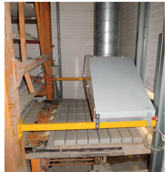
L'une des deux hottes chauffées, installée entre le descendeur et la cloison de la chambre, empêche tout échappement d'air chaud et humide et empêche ainsi que des gouttes d'eau de condensation ne tombent sur les blocs frais.
