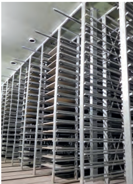
Conduites de distribution d'air, situées à l'intérieur de la chambre, permettant de réguler la distribution d'air et de limiter la vitesse de l'air à une valeur inférieure à 1,00 m/s.
