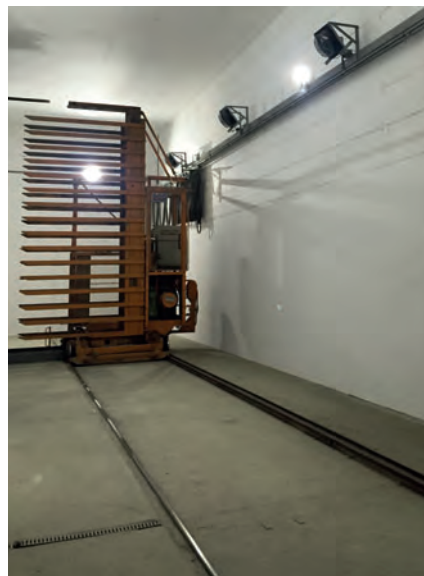
Grâce au système de circulation d'air dans l'allée du pont roulant, cette zone, ainsi que le chariot transbordeur, restent secs. Il ne s'y forme aucune eau de condensation, ni aucun brouillard, qui pourraient conduire à une possible perte de la mesure par laser des trajets réalisés par le chariot transbordeur.
