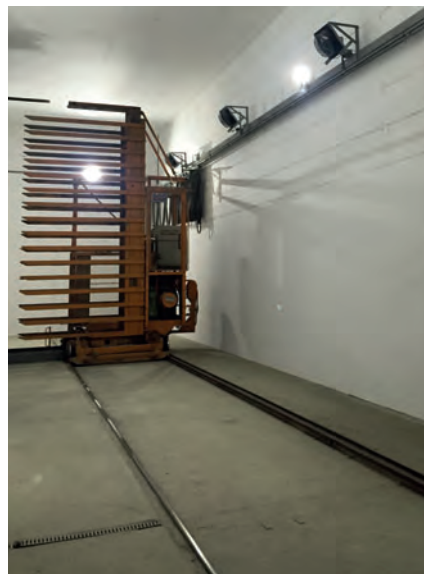
La circulación de aire en el paso de la plataforma corrediza mantiene esta zona, así como el transelevador, secos. No se condensa el agua y no se forma niebla, lo que podría conducir a un fallo en la medición del recorrido del transelevador mediante láser.
