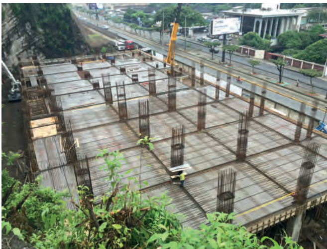
En agosto de este año se terminó un aparcamiento de cinco plantas en la Universidad Católica de Guayaquil. Se ha previsto una ampliación a 7 plantas.
