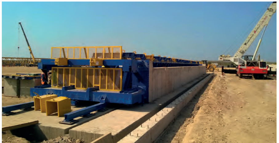
El encofrado de 40 m se instaló cerca de la obra. Se puede utilizar de forma independiente del lugar, ya que cuenta con un sistema para absorber las fuerzas de pretensado
