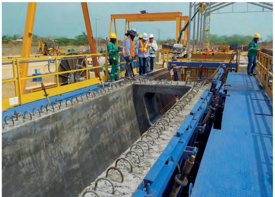
Ein Vibrations- und Heizungssystem sorgen für eine gleichmäßige Verdichtung und Aushärtung des eingebrachten Betons. Für das „viaducto Gran Manglar“, der längsten Straßenbrücke Kolumbiens, werden V-Träger in drei verschiedenen Längen und mit einem Gewicht von bis zu 85 t produziert.
