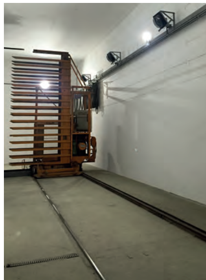
Durch die Luftzirkulation im Schiebebühnengang bleiben dieser Bereich sowie die Fahrzeuggruppe trocken. Es bildet sich kein Kondenswasser und kein Nebel, welcher zu einem möglichen Ausfall der Wegstreckemessung der Fahrzeuggruppe mittels Laser führen könnte.
