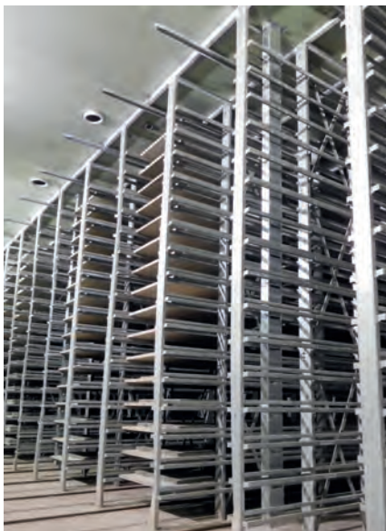
Luftverteilungsleitungen innerhalb der Kammer zur Regulierung der Luftverteilung und Begrenzung der Luftgeschwindigkeit auf unter 1 m/s.
