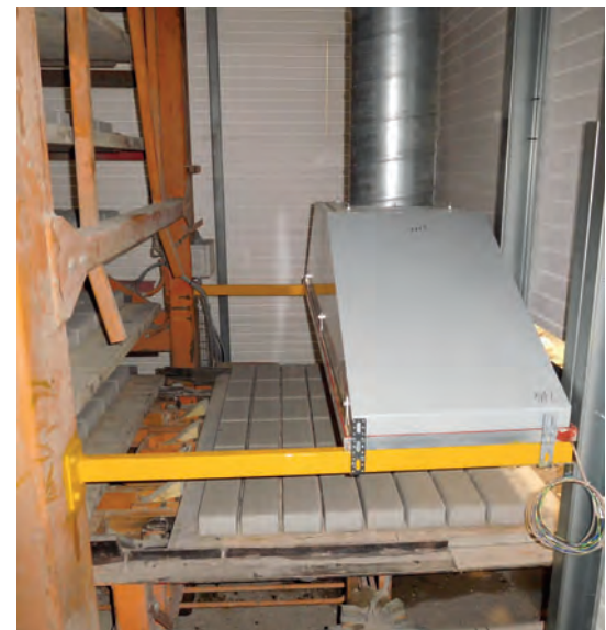
Eine von zwei beheizten Hauben, installiert zwischen der Senkleiter und der Kammerwand, verhindern das Austreten von Warm- und Feuchtluft, sodass dabei keine kondensierten Wassertropfen auf die frischen Steine gelangen.
