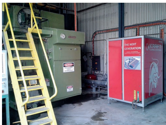
Рис. 3: Компактный парогенератор Kraft Curing KC 20 – 1S (справа) пришел на смену старому паровому котлу. Парогенераторы Kraft занимают намного меньше места, чем традиционные котлы аналогичной мощности
