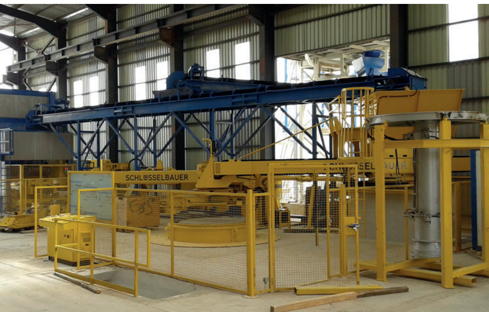
Impianto di produzione dei tubi Exact XL nella fabbrica di Trans-Canal Centre ad Algeri.
