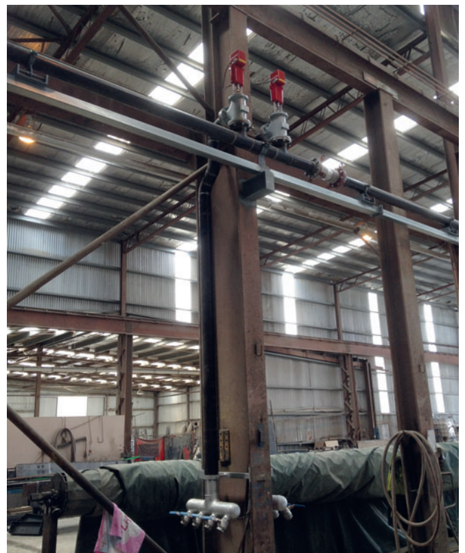
Fig. 4: Las válvulas de vapor controladas automáticamente regulan la cantidad de vapor de las diferentes zonas de curado y la temperatura del hormigón que se desea durante los diferentes ciclos de curado
