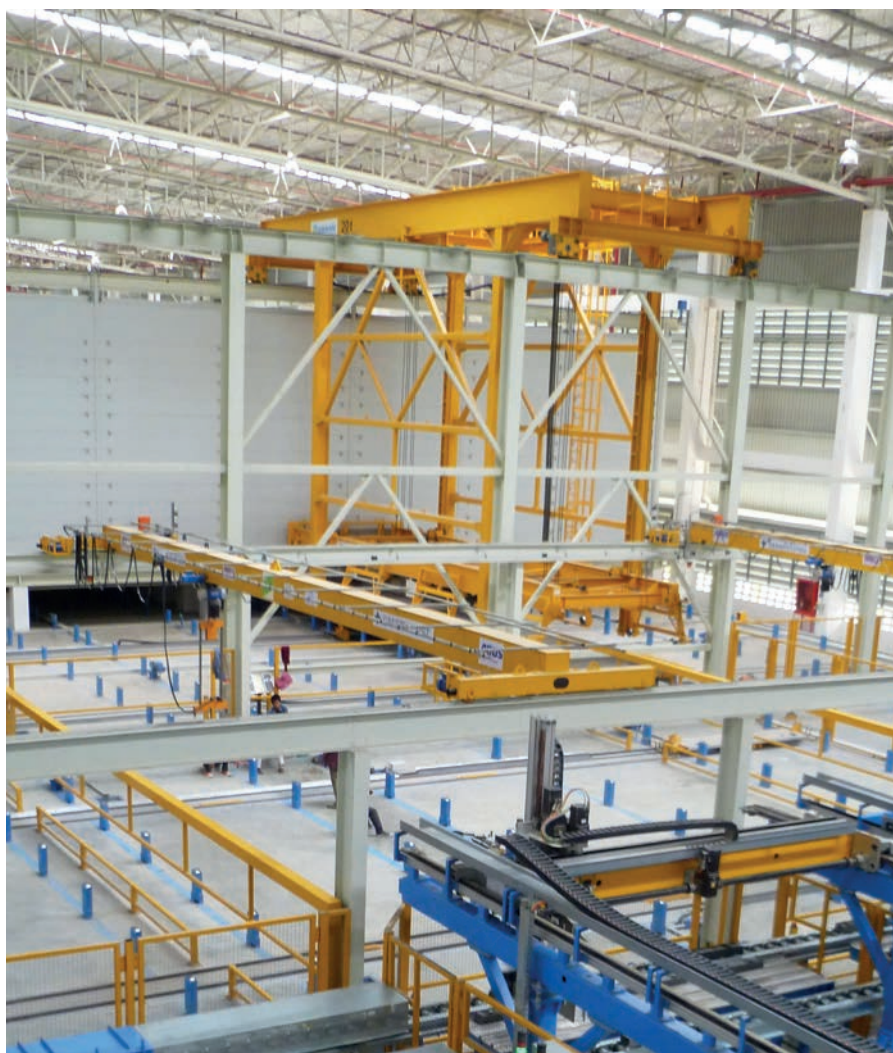
Погрузка и выгрузка паллет в камеры выдержки осуществляется при помощи полностью автоматического стеллажного штабелера. Система управления ebos® рассчитывает необходимое время выдержки и передает эти данные на линию
