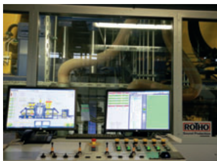
Accanto alla blocchiera è installato il posto di manovra. Un grande pannello vetrato consente lo sguardo alla blocchiera
