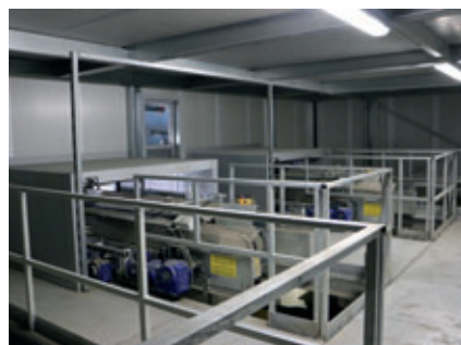
Cabina insonorizzata con galleria
