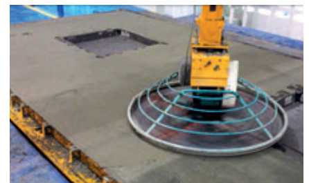
La nouvelle usine près de Bangkok est dotée de 6 truelles mécaniques et de 24 emplacements de lissage pour assurer la finition de surface des éléments. La commande entièrement automatique a permis de réduire les cadences pour le lissage à un minimum et de comptabiliser d'énormes économies sur la main d'œuvre.
