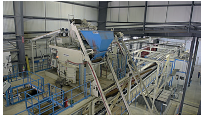
Malaxeurs de béton de corps et de parement
