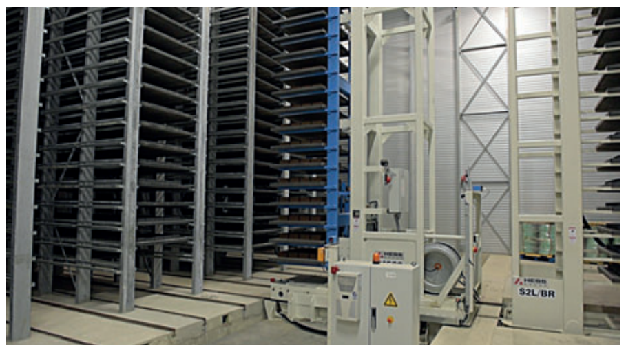
Chariot transbordeur dans la chambre de séchage
