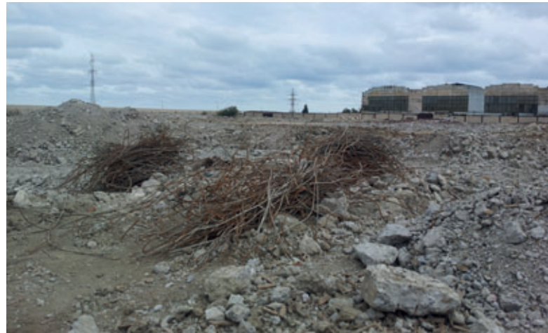
El terreno de la fábrica Star CP el día de la primera visita a las obras
