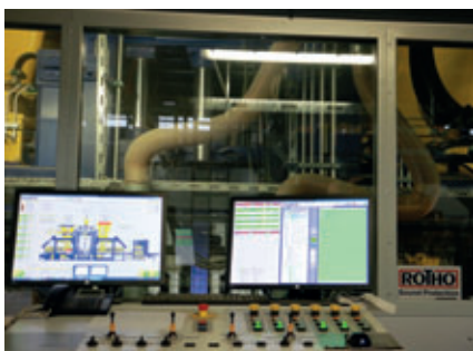
Al lado de la máquina bloquera se ha instalado el panel de mando. Una gran ventana ofrece una visión sobre la máquina bloquera
