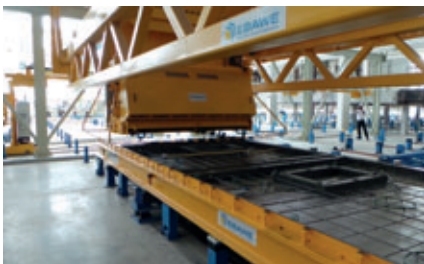
Der Betonverteiler bei Pruksa kann über die gesamte Palettenbreite austragen werden. Dies führt zu einer enormen Zeitersparnis im Produktionsablauf.
