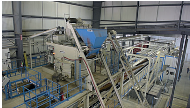
Kernbeton- und Vorsatzmischer
