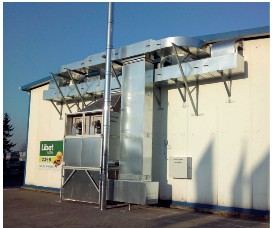
Компактная установка Quadrix® смонтирована с обратной стороны теплоизолированной камеры выдержки в специальной погодостойкой капсуле. Теплоизоляция воздуховодов препятствует потерям энергии. Нагревательный прибор и вытяжная труба облицованы высокосортной листовой сталью
