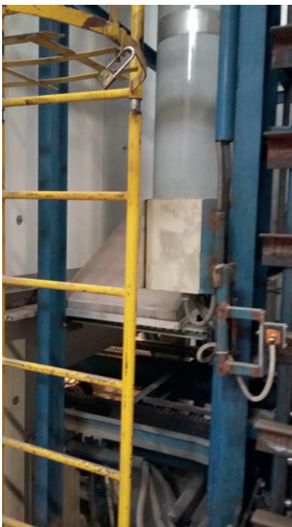
Два обогреваемых вытяжных колпака, смонтированных между опускным штабелером и наружной стеной камеры, препятствуют выходу теплого влажного воздуха из камеры и выпадению капельного конденсата на бетонные блоки
