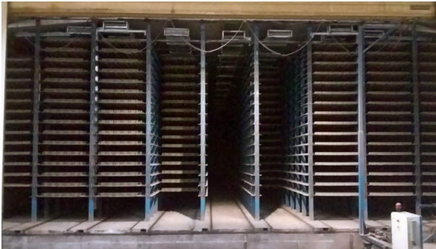
Над стеллажами смонтированы оцинкованные приточные и обратные воздуховоды. Они не занимают практически никакого места. Пол остается сухим при влажности воздуха 95%
