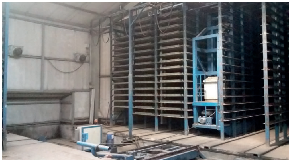
Воздушная циркуляция в проходах предотвращает образование тумана и выход из строя лазерных датчиков транспортной группы
