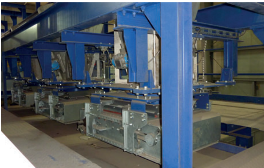
I nastri trasportatori possono essere orientati di ca. 30° verso sinistra oppure verso destra, partendo dalla posizione centrale, durante il dosaggio del calcestruzzo colorato.
