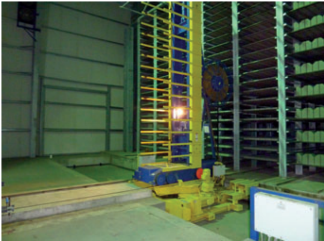
Carrello multi-forche Masa nella camera di maturazione con il sistema di scaffalature Rotho
