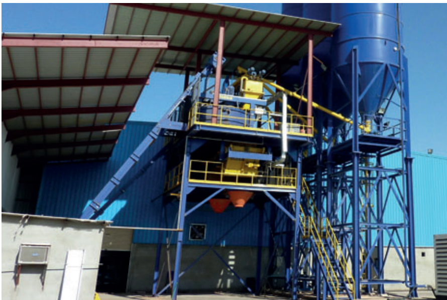
Aperçu de la tour de malaxage de Masa : les vis à ciment transportent chacune le ciment dans une balance à ciment des malaxeurs Masa S 350/500 et PH 2000/3000
