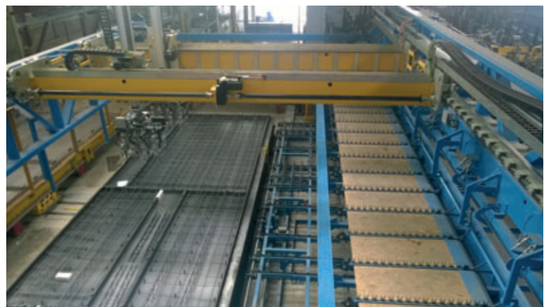
Wire Center : automate de traitement de l'acier avec robots
