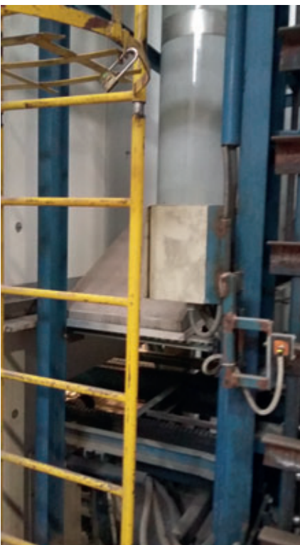
Una de las dos campanas calefactables, instalada entre el descensor y la pared exterior de la cámara, evita la salida de aire caliente y húmedo de la cámara de curado y que las gotas de agua condensada lleguen a los bloques frescos.
