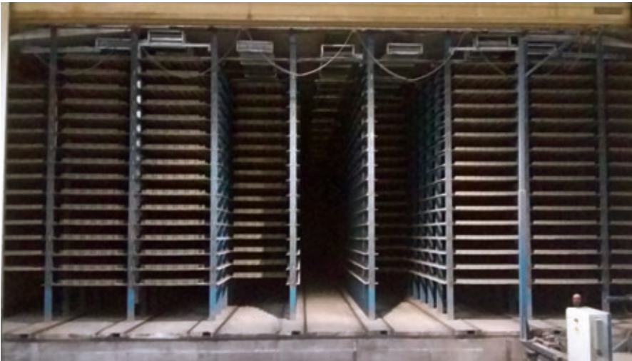
Los canales de alimentación y retorno galvanizados están montados por encima de la instalación de estanterías. De este modo no quitan espacio. El suelo de los pasillos está seco, desde el comienzo hasta el final, y esto a una humedad del aire del 95%.
