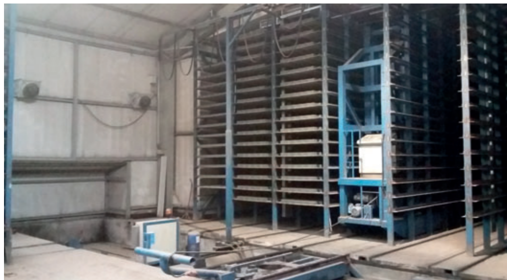
Gracias a la circulación de aire en los pasillos, esta zona y el carro multiforca se mantienen secos, no se condensa el agua en el techo y no se forma niebla, lo que podría conducir a un fallo en la medición del recorrido del carro multiforca mediante láser.
