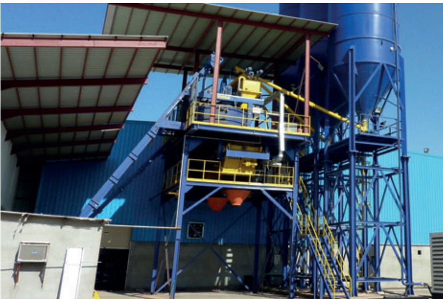
Vista de la torre mezcladora Masa: los transportadores de cemento helicoidales transportan el cemento a las respectivas básculas de cemento de las mezcladoras Masa S 350/500 y PH 2000/3000
