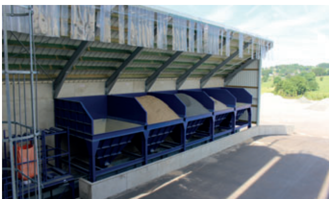
Les cinq silos de granulats pour le béton de parement
