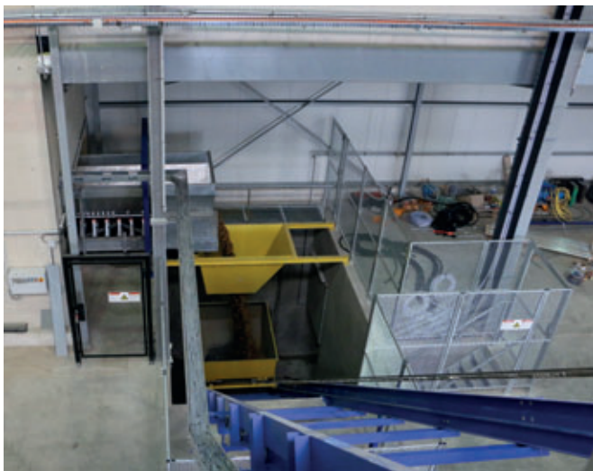
El elevador está equipado con un arranque suave y traslada los áridos al nivel superior de las mezcladoras.
