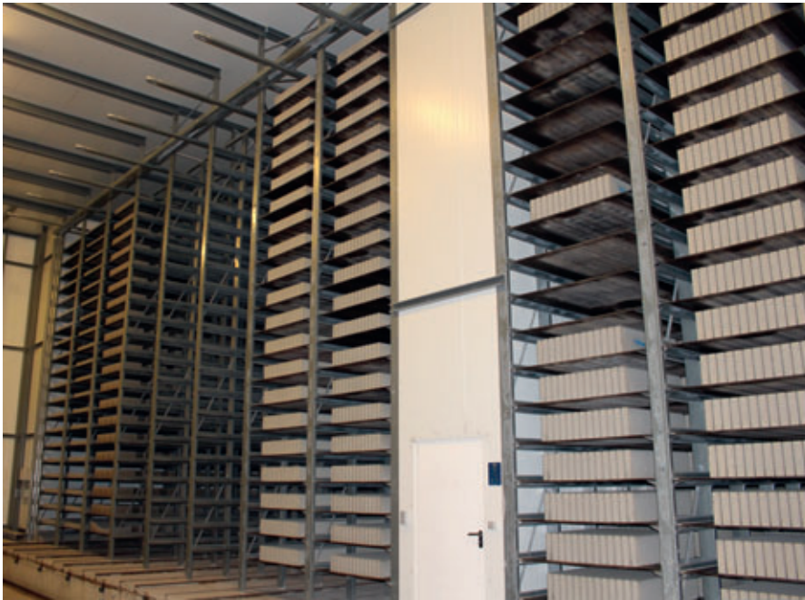
Die von HS Anlagentechnik bei Rewa montierte Härtekammer hat insgesamt 16 Kammern mit jeweils 20 Etagen und einer zusätzlichen Leerkammer.
