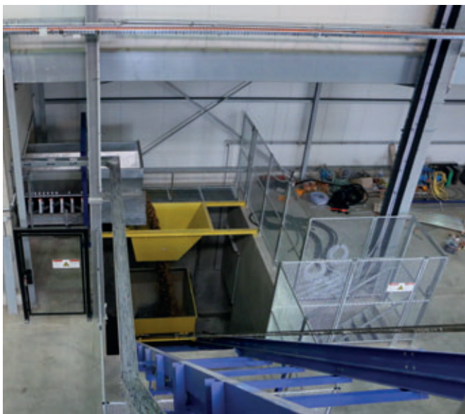
Der Aufzug ist mit einem Sanftanlauf ausgestattet und bringt die Gesteinskörnungen in die höhere Mischerebene.
