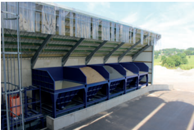
Die fünf Gesteinskörnungssilos für den Vorsatzbetonmischer
