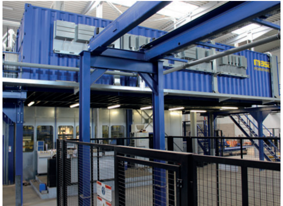
Die gesamte Elektronik befindet sich im Masa-Powertainer.
