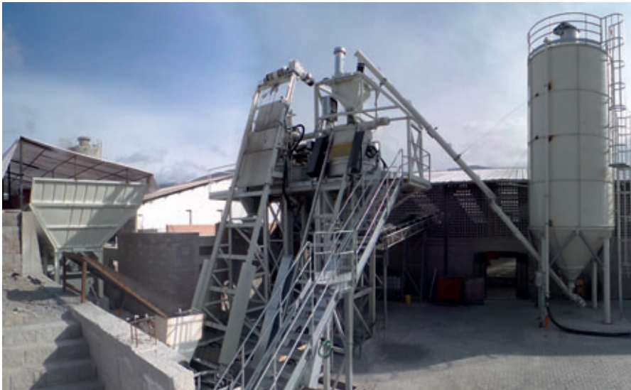
Impianto di betonaggio Euromecc con silo per il cemento, tramogge, elevatore a benna e miscelatori
