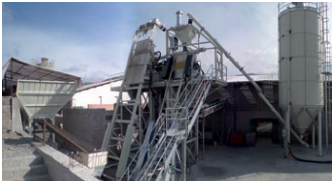
Installation de mélange de la société Euromecc avec silo à ciment, trémies, élévateur à benne et mélangeurs
