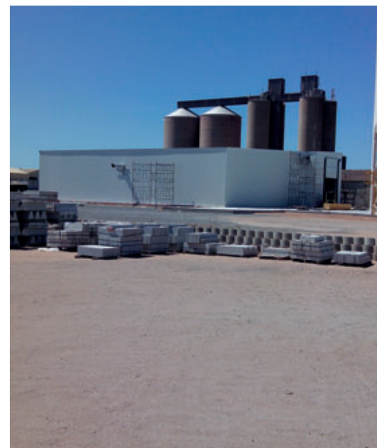
Aislamiento exterior de las estanterías de curado, portón de apertura rápida y sistema de circulación de aire después de su finalización
