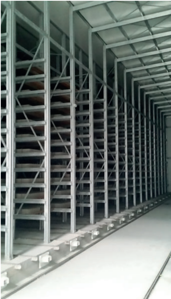
Ambiente uniforme dentro de la cámara de curado con temperatura y humedad relativa del aire estables, sin condensación en el techo, suelo, estanterías de acero o rieles. El aislamiento, la circulación de aire y la regulación de la humedad son de importancia decisiva en este entorno de curado/producción
