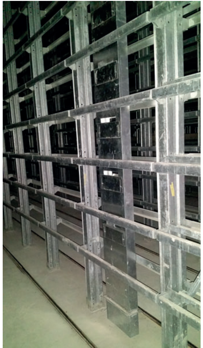
Uno de los 15 pozos de aire distribuidos dentro de la cámara. Cada pozo de aire tiene salidas de aire regulables en cada nivel para un ambiente totalmente estable con una velocidad de aire continuamente baja para evitar la evaporación de la humedad de la superficie de hormigón
