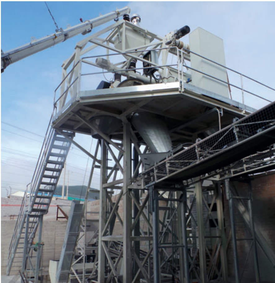
Euromecc Mischer und Bandförderer für die Versorgung des Mehrlagenfertigers
