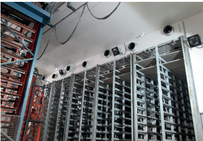
После: изолированная зона с передаточной тележкой, система кондиционирования и подачи теплого воздуха
