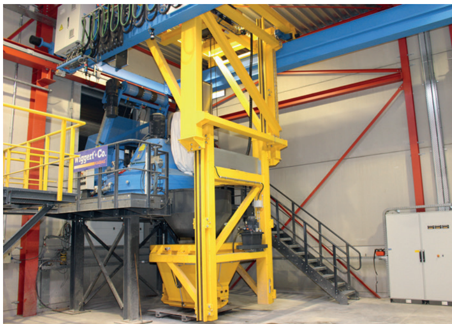
Дозирующая установка включает в себя специальную бетонораспределительную машину фирмы Ebaue и планетарный смеситель фирмы Wiggert
