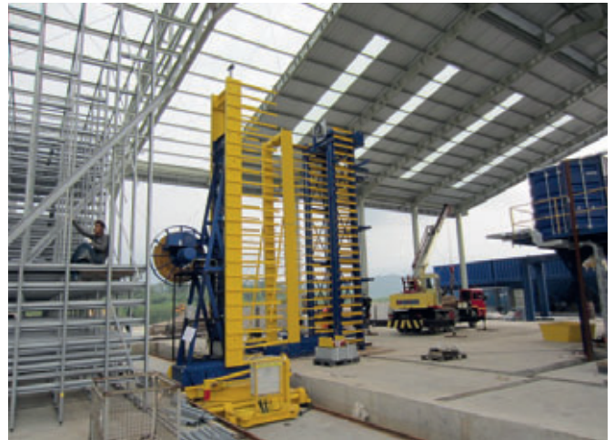
Si installa il nuovo impianto di scaffalatura per la camera di maturazione
