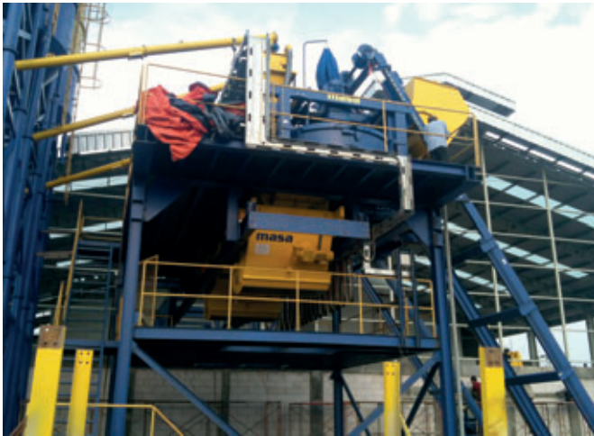
Vista sulla nuova macchina PH 1500/2250 Masa e sul trasportatore a vagonetti, doppio, sottostante
