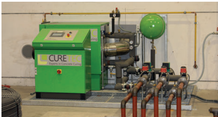
Système de chauffage CureTec
