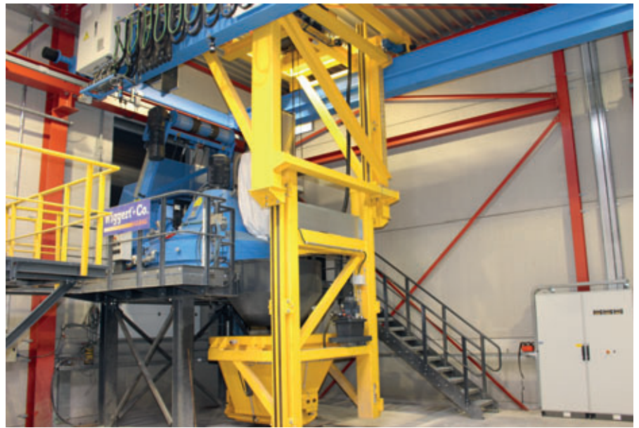
L'installation de mélange abrite un distributeur de béton spécial d'EBAWE et un malaxeur planétaire de Wiggert
