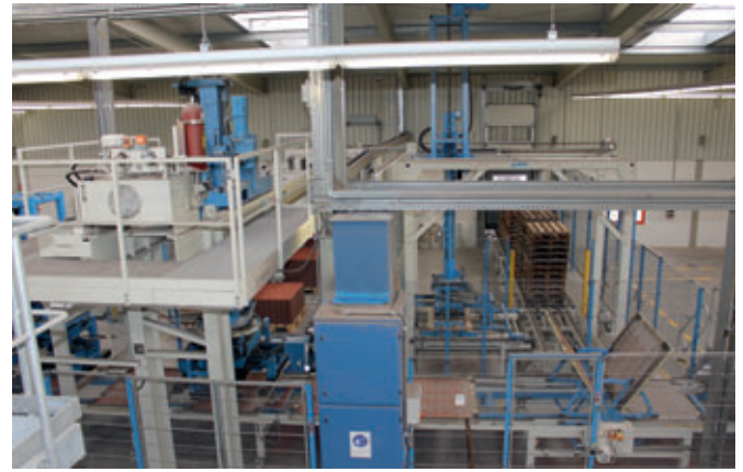
Les planches de support vides sont nettoyées, retournées puis stockées dans le rayonnage tampon pour planches ou sont transportées jusqu'à la machine de production de blocs de béton avec le chariot transbordeur.
