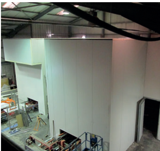
Después: Ascensor y descensor completamente encapsulados
