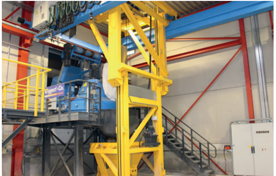
La central de hormigonado incluye un distribuidor de hormigón especial de EBAWE y una mezcladora planetaria de Wiggert
