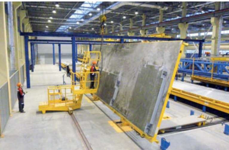
Zur Entnahme der fertigen Wandelemente werden die Paletten mit einer Kippeinrichtung in eine nahezu vertikale Position gebracht. Eine fahrbare Treppe erleichtert dabei den Prozess für den Bediener.
