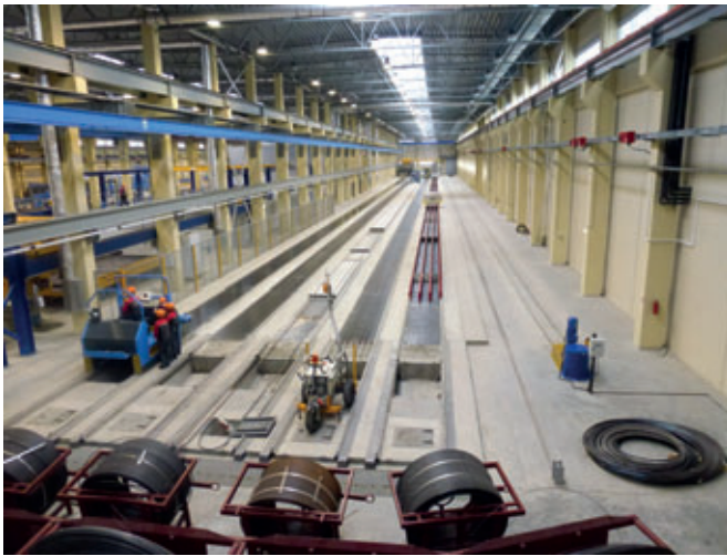
Auf insgesamt 5 Produktionsbahnen mit einer Länge von je 126 m werden mit einem Gleitfertiger vorgespannte Betonfertigteile hergestellt.
