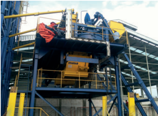
Blick auf die neue Masa PH 1500/2250 und der darunterliegenden Doppelkühelbahn
