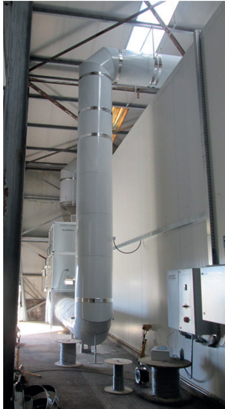
Nachher: Isolierte Edelstahlheizung mit Aluminiumrahmen – 50 % weniger Leistung als Vorgängermodell. GFK-Kanal (glasfaserbeschichtet – Innen- und Außenwände) mit 50 mm Polyiso-Isolierung. Nut-und-Feder-Konstruktion mit Edelstahl-Schellen an allen Verbindungsstellen. Dämmplatten auf Kammerwänden und Decke in Nut-Feder-Ausführung mit dichten U-Kanälen am Boden und isolierten und dichten Verbindungsstellen.
