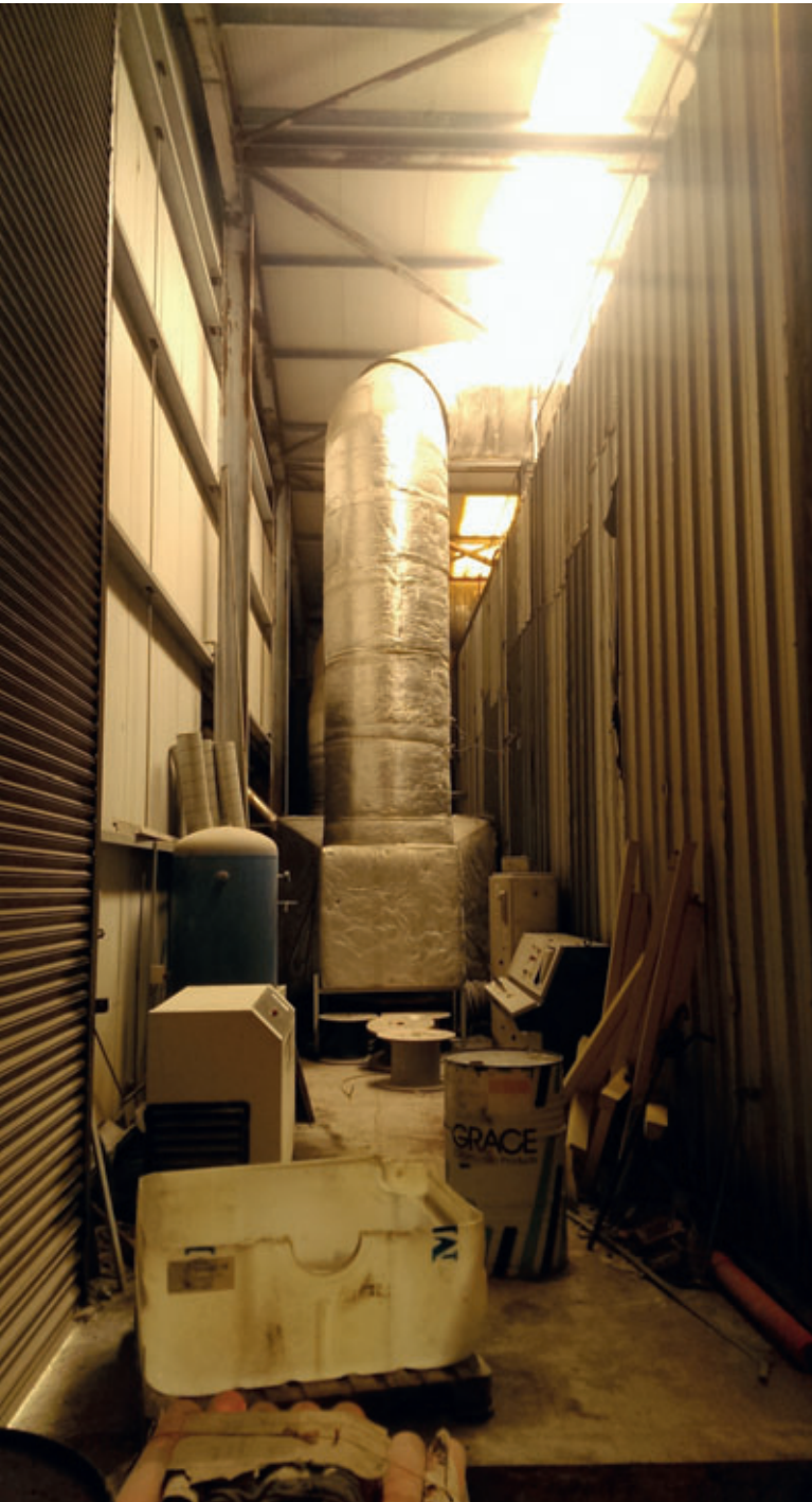
Vorher: Überdimensionierte Heizung, „isoliert“ mit folienbeschichteter Glaswolle, befestigt mit Maschendraht. Die Dämmplatten auf der Kammer waren undicht und die Fugen (zwischen Wand- und Deckenplatten) waren nicht abgedichtet.
