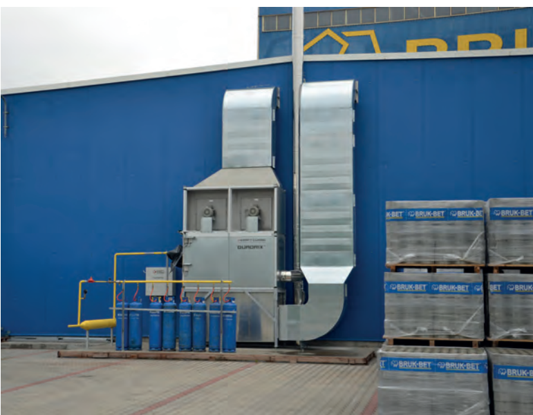
Воздушный нагревательно-циркуляционный блок Quadrix снаружи камеры тепловлажностной обработки до сооружения навеса
