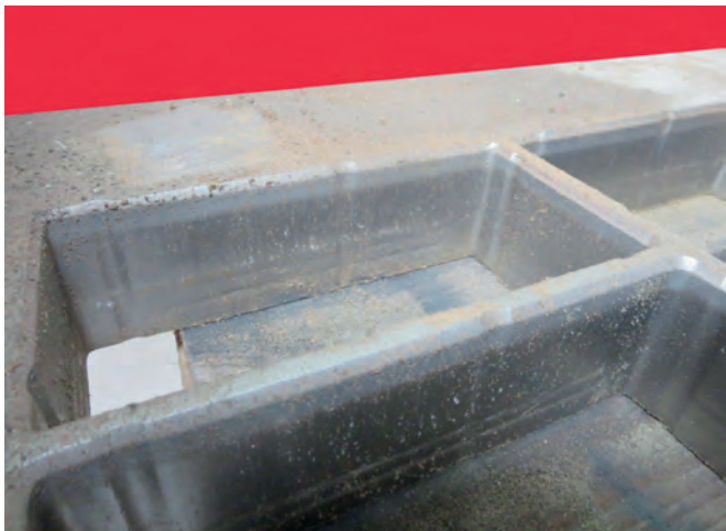
Износ в зоне виброуплотнения
