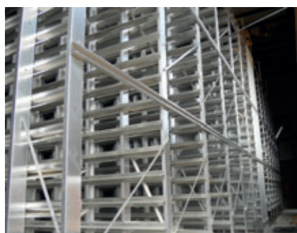
La camera di tempra, montata da HS Anlagentechnik, dispone di 22 piani con una distanza di 330 mm tra un piano e l'altro.
