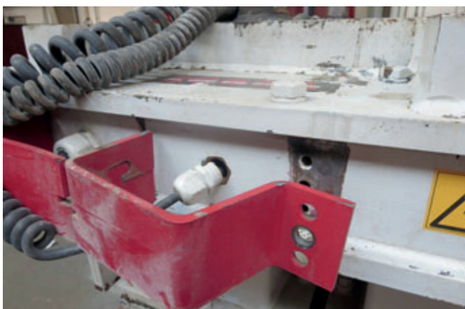
Danni da movimentazione / manutenzione errata
