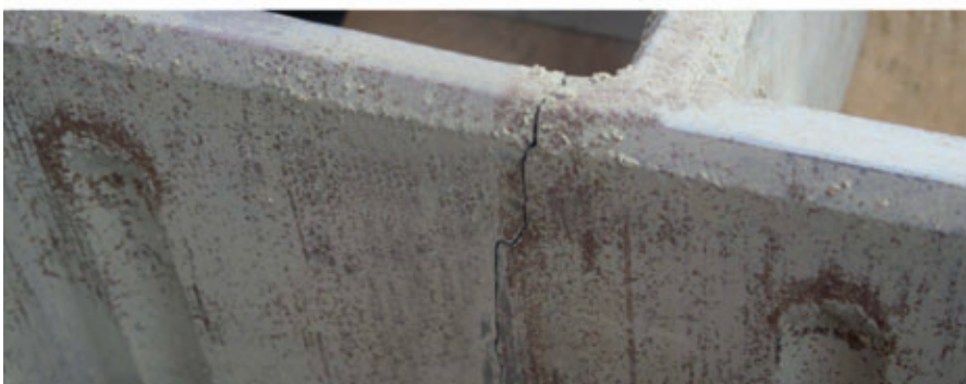
Sollecitazione eccessiva / crepe
