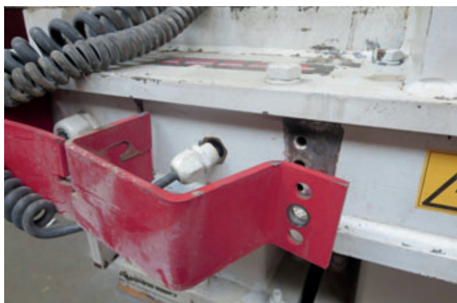
Dommages dus à une mauvaise manipulation / maintenance
