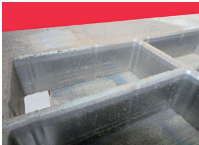
Usure au niveau du compactage
