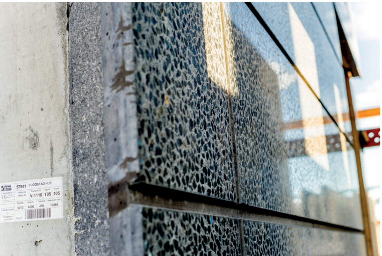
Vista en detalle de un elemento prefabricado de hormigón con tratamiento superficial
