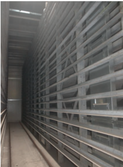
Fotografía tomada durante el curado a una temperatura de 35 °C (100 °F) y una humedad relativa del aire del 100 %: solado seco, raíles y estanterías. El canal de aire con persianas se encuentra al lado, a la derecha de la fotografía
