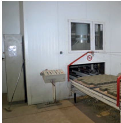
Nasseiteneingang / Trockenseitenausgang der Erhärtungskammer für die frischen/ausgehärteten Betonwaren, mit Fenster, gedämmter Wand und Abzug mit beheizter Haube, um das Entweichen von Feuchtigkeit in den Produktionsbereich und Tropfen auf den frischen Produkten zu vermeiden.
